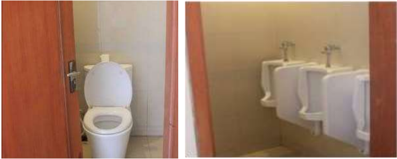
Foto 2.7 Kondisi toilet di Pura Taman Ayun
